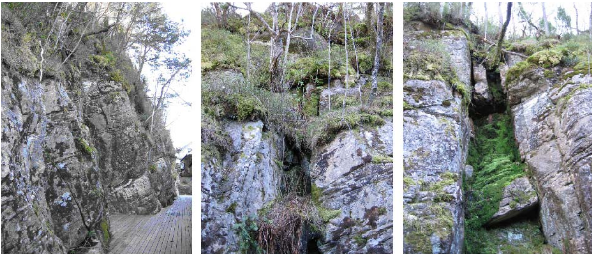
Figur 7. Bilder som viser bergvegg fra terrasse i 2. etasje og oppover. Bildene lengst til høyre viser kiler med løse blokker og vegetasjon.
