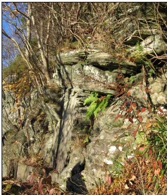
Figur 4 Mur med løse blokker over Salhusvegen 103.
