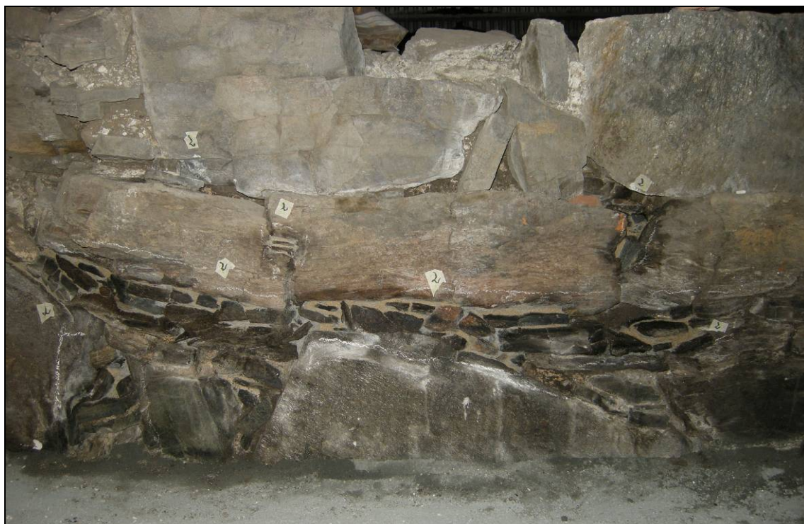
Figur 20. Et parti nederst i ytre murliv på nordmuren etter reparasjon med kalkmørtel. Se figur 21 (foto: Byantikvaren).
