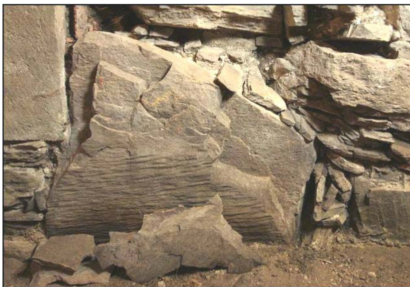
Figur 24. Bruddstein med avskallinger i ytre murliv i nordlig langmur (foto: Byantikvaren).
