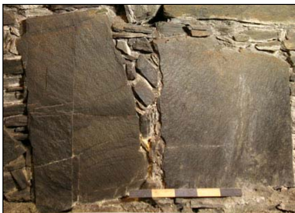
Figur 15. Før: Et parti nederst i ytre murliv på nordmuren før reparasjon. Se figur 18 (foto: Byantikvaren).
