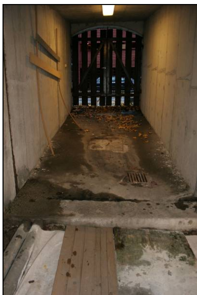
Figur 45. Før tiltakene i 2006: inngangspartiet var lite funksjonelt og estetisk (foto: Byantikvaren).
