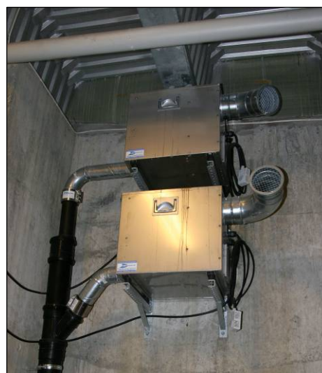
Figur 39. For å bedre inneklimaet ble to avfuktere (adsorpsjonsavfuktere) montert på vestveggen i ruinrommet (foto: Byantikvaren).
