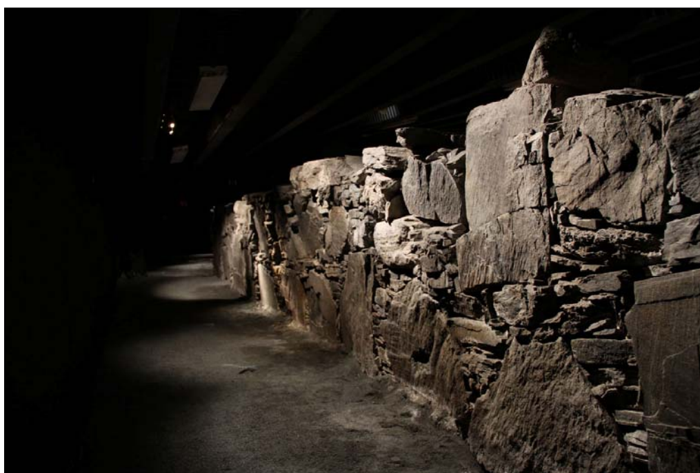
Figur 43. De mørke omgivelsene i ruinrommet samt ny lyssetting med spotlights fra himlingen, bidrar til at fokuset nå rettes mot ruinen. Her er ytre murliv i søndre langmur avbildet (foto: Byantikvaren).
