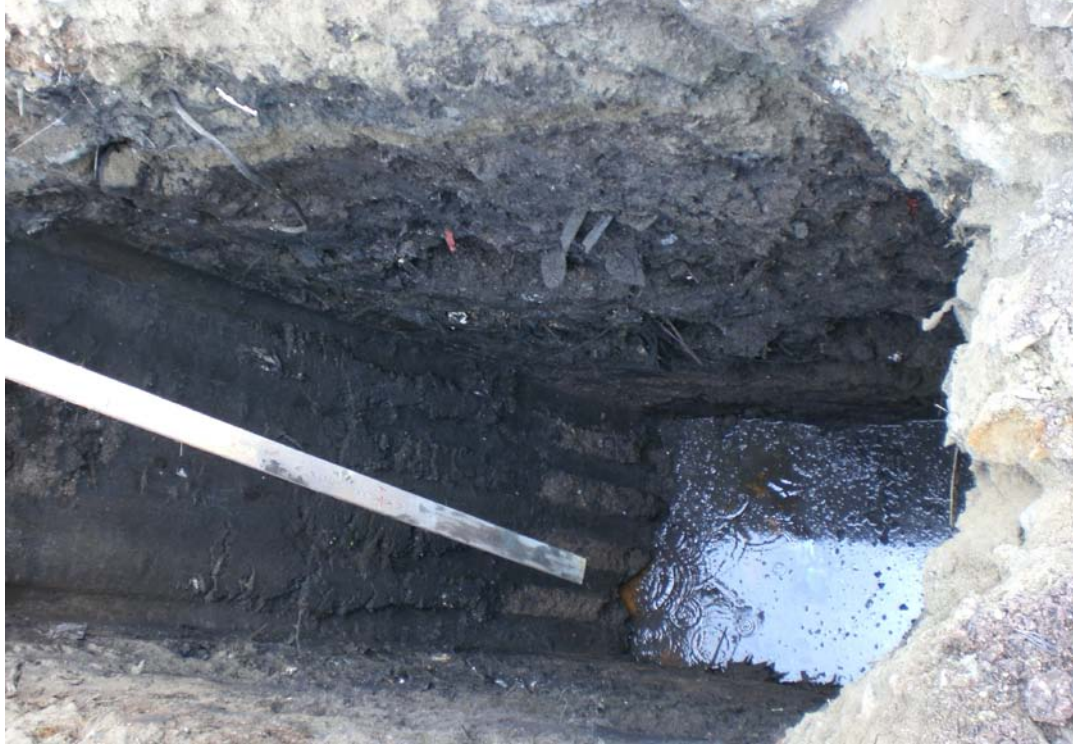
Foto 6-1. Sjakt 6. Relativt tørt avfall. Jernbrunt vann pipler inn fra ca 5 meter under terreng, der det er fjell. Sjaktveggene er stabile, og massene er gravbare.
