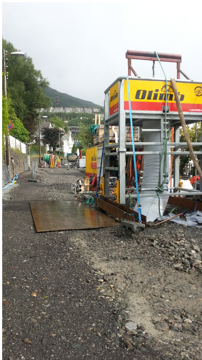
Oppgradering av Ibsens gate del 1. Fornyng av avløpsledninger ved å føre en polyesterstrømpe inn i rørene. (Foto, Einar Høgmo)
