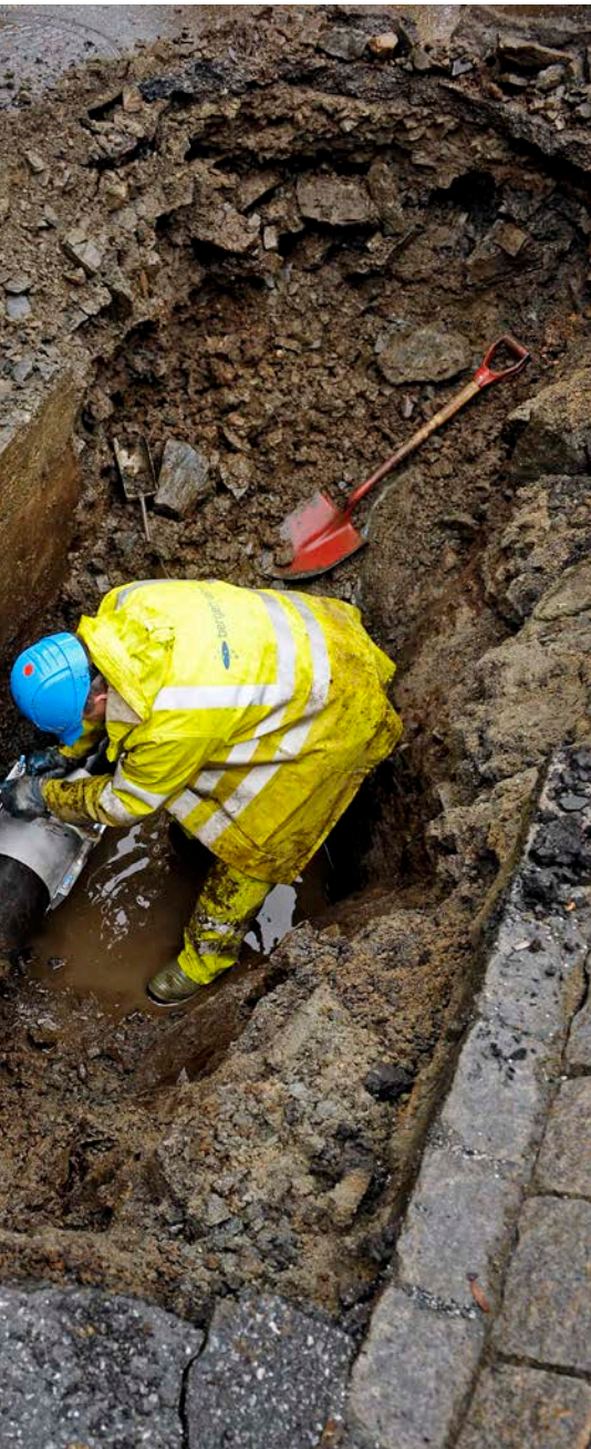
Det kan bli dyrt å reparere ledninger som ligger i kjørevei. (Foto, Helge Skodvin)
