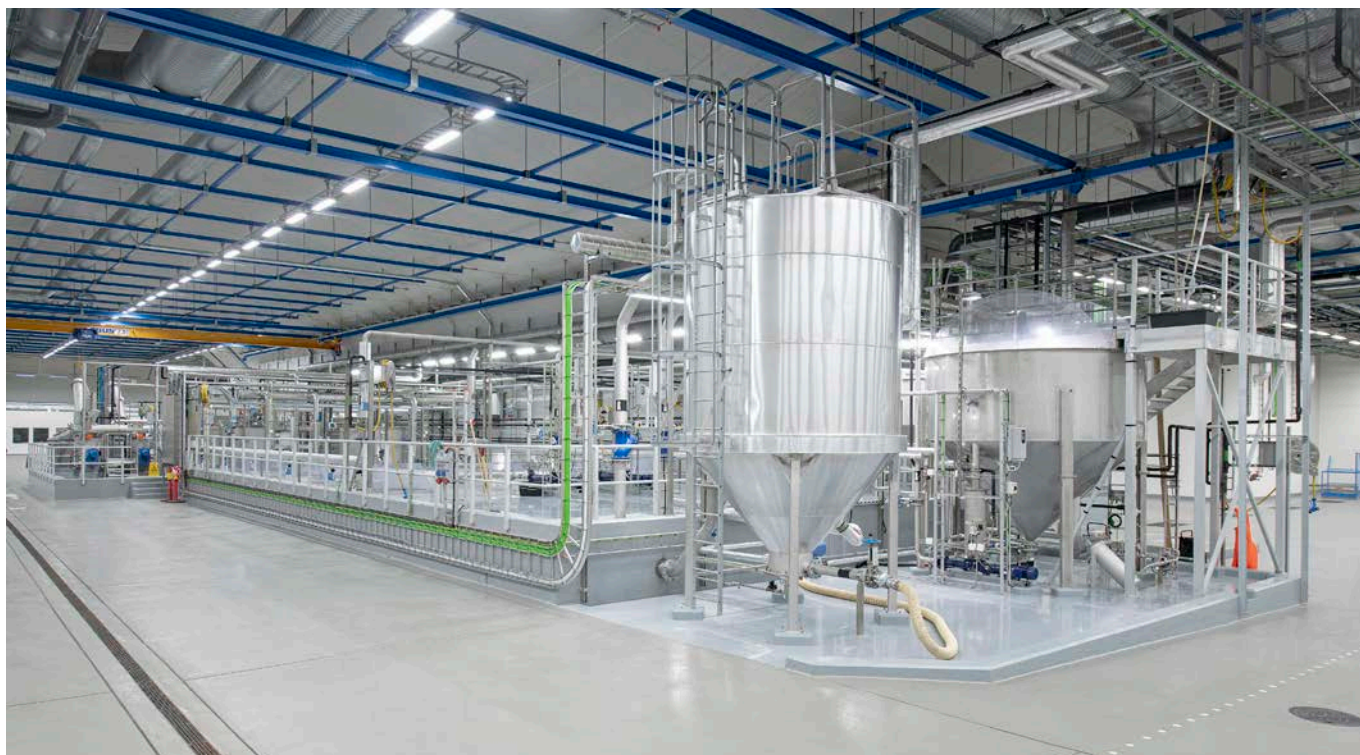
Kvernevik avløpsrensanlegg. Etter grovristen, der alt boss blir fjernet kommer avløpsvannet hit til fett- og sandfanget. Her fjernes fett og sanden. Fettet samles i tankene på enden av prosessen. (Foto, Helge Skodvin)
