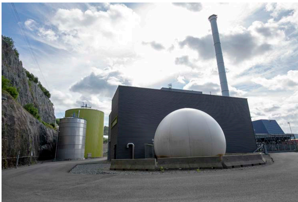
Gassklokken i front og råmetankene bak til venstre på biogassanlegget. (Foto, Helge Skodvin)
