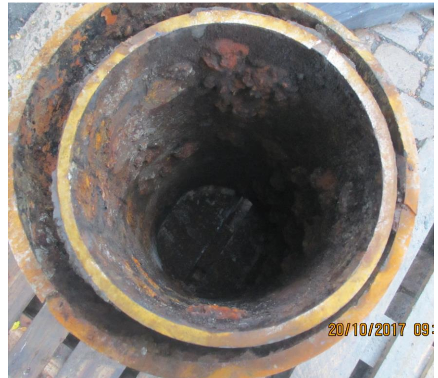
Vannledning fra ca 1885 Kong Oscars gate
