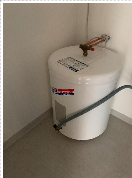
Bilde nr. 3.08 Mindre varmtvannsbereder kontorlokaler
