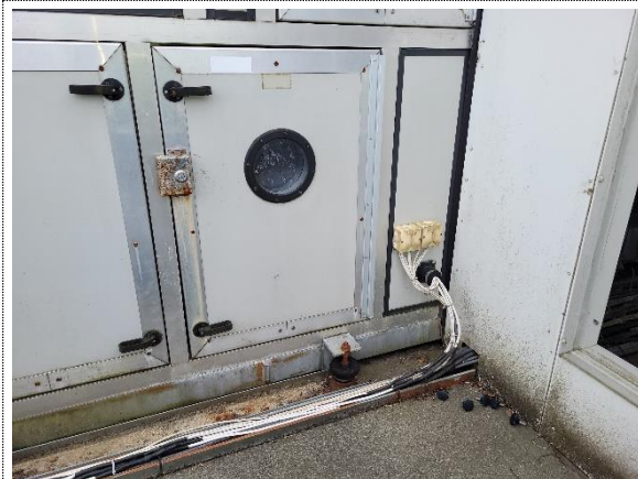
Bilde nr. 3.14 Luftbehandlingsanlegg blokk C og D
