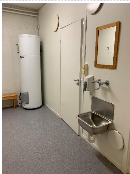
Bilde nr. 3.07 Varmtvannsbereder dusjanlegg
