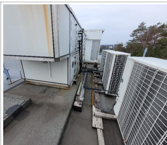
Bilde nr. 3.12 Luftbehandlingsanlegg blokk C og D
