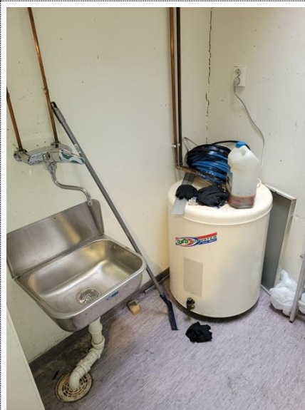
Bilde nr. 3.04 Utslagsvask og varmtvannsbereder
