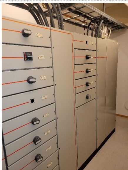
Bilde nr. 4.05 Hovedfordeling med underfordeling
