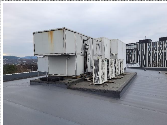
Bilde nr. 3.16 Luftbehandlingsanlegg blokk E og F
