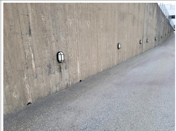
Bilde nr. 7.08 Støttemur ved tilkomstvei mot parkering
