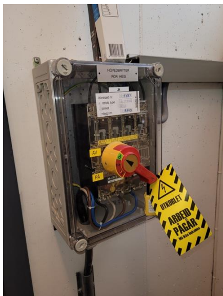
Bilde nr. 4.13 Heis avstengt i bygg E
