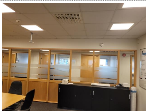
Bilde nr. 3.17 Tilluft i møterom
