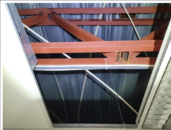
Bilde nr. 2.12 Stålbæring i underkant av Q-dekke.
