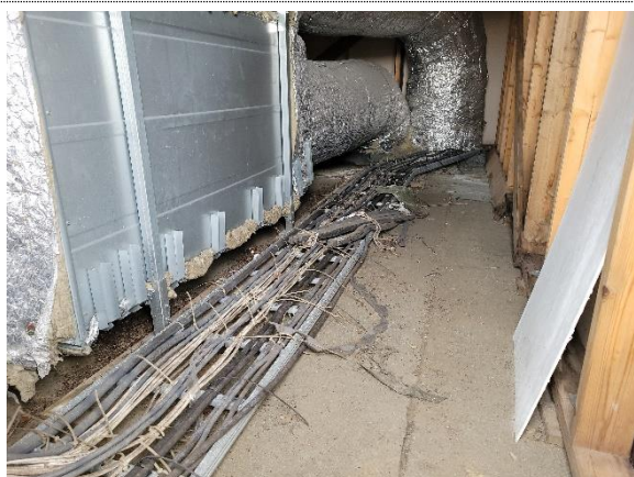
Bilde nr. 3.15 Luftbehandlingsanlegg blokk C og D
