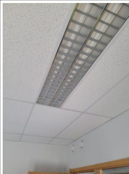
Bilde nr. 4.06 Eksempel på lysarmaturer
