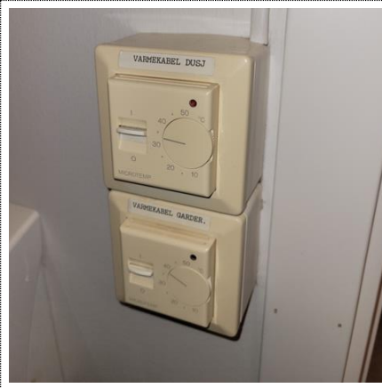
Bilde nr. 4.10 Varmekabel dusj og garderobe
