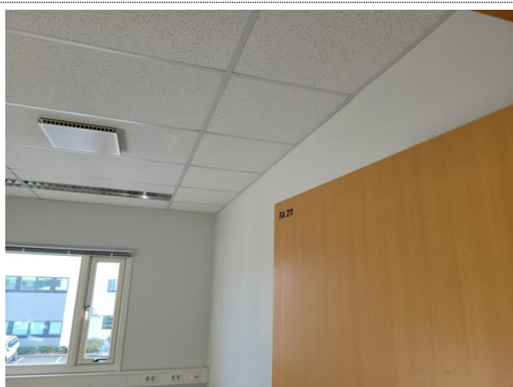
Bilde nr. 2.51 Systemhimling bygg A
