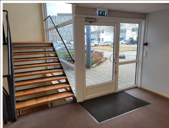
Bilde nr. 4.08 Nødlysutstyr
