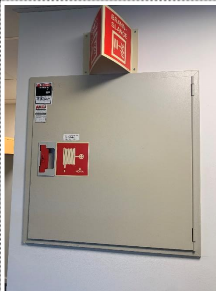
Bilde nr. 3.10 Brannslange
