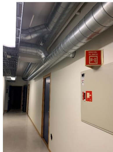
Bilde 10 Ventilasjonskanaler i kjelleretasje
