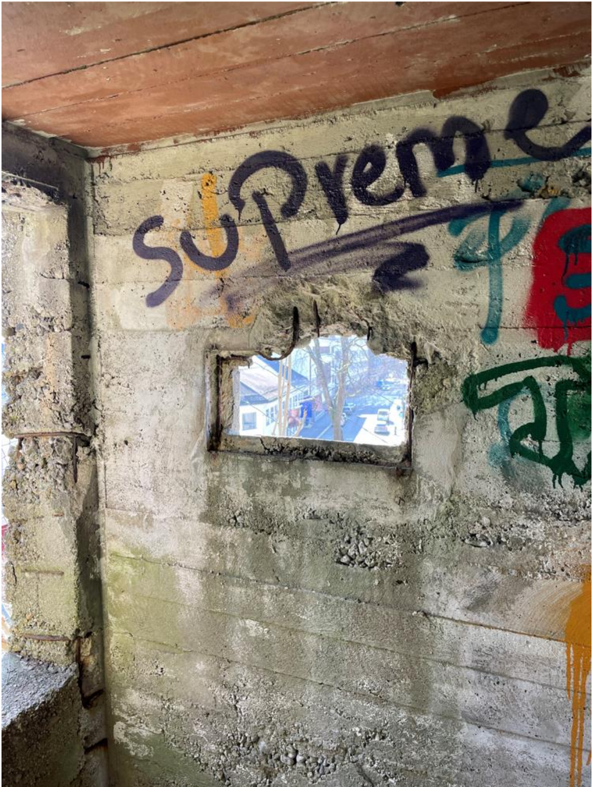
Figur 1-17: Detaljer. Interiør og skyteskår med forvitret overkant med synlige armeringsjern. Bordforskaling. Nyere tagging på overflater. Foto: Asplan Viak.
