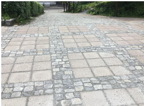
Figur 3-59 Dekke i krysset Tullins gate/ Welhavens gate. Betongheller i brostein, granittkant. Fremstår med god kvalitet
