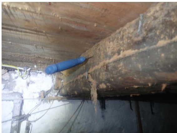
Bilde 5: Skader på bjelkelag over kjellar
