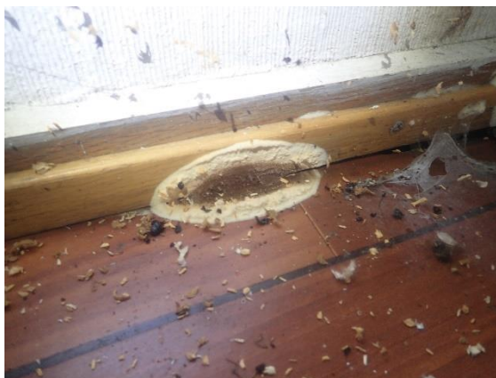
Bilde 10: Soppvekst i overgang golv/yttervegg
