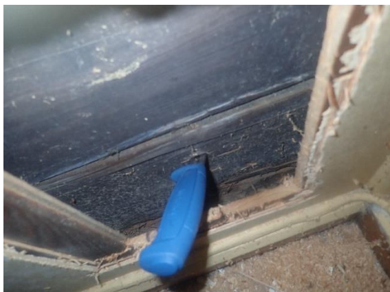
Bilde 3: Råteskader i botn av tømmervegg
