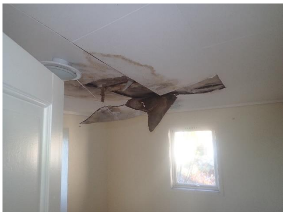
Bilde 9: Fuktskade i etasjeskillere
