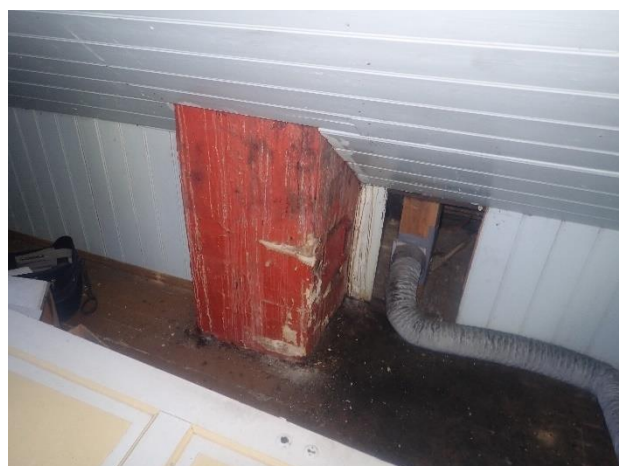
Bilde 8: Puss på pipe på loft er forurenset av metaller
