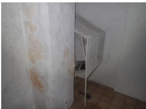
Bilde 7: Maling på pipe på soverom i 1. etasje er forurenset av metaller
