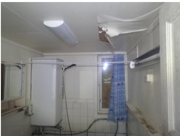
Bilde 13: VVB, varmeovn og lysarmatur på bad
