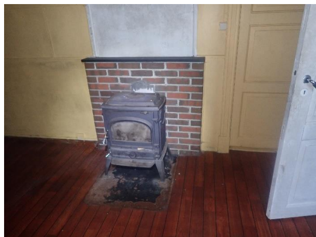
Bilde 6: Maling på brannmur i stue i 1. etasje inneholder bly og sink over grensen for farlig avfall.
