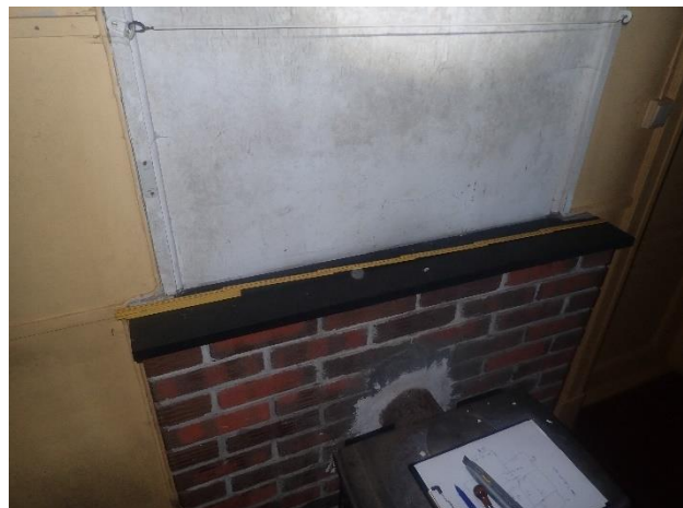
Bilde 4: Maling på brannmur i stue i 1. etasje er forurenset av PCB
