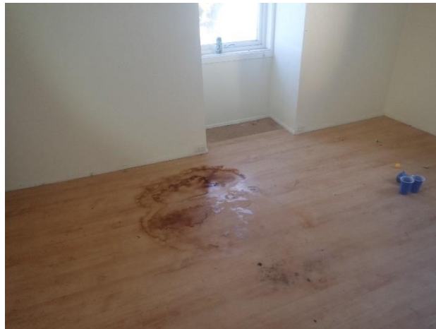
Bilde 10: Eldre vinylbelegg i 2. etasje
