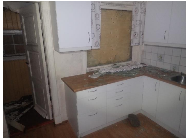
Bilde 12: Knust isolerglassvindu i 1. etasje
