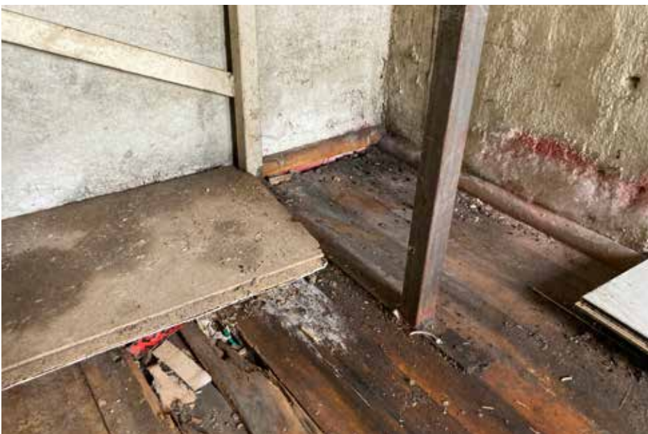
Rom 2. Fukt i golv.
