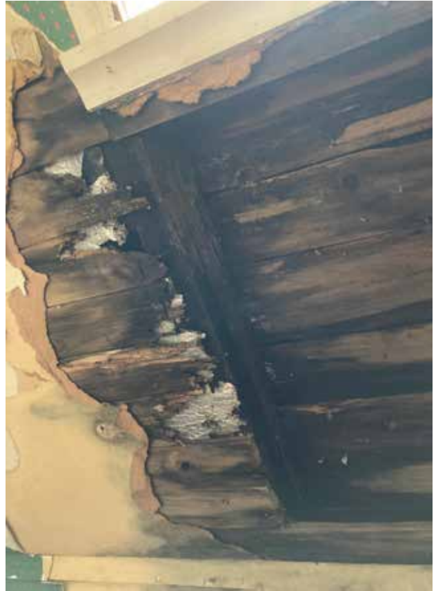
Rom 2, fukt frå tak/takvindaug.
