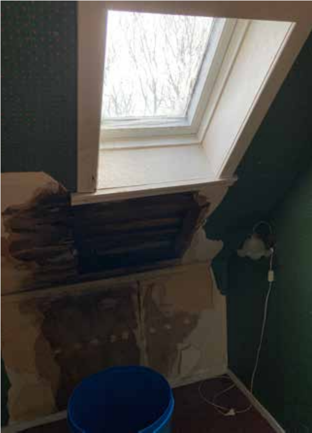
Rom 2, fukt frå tak/takvindaug.
