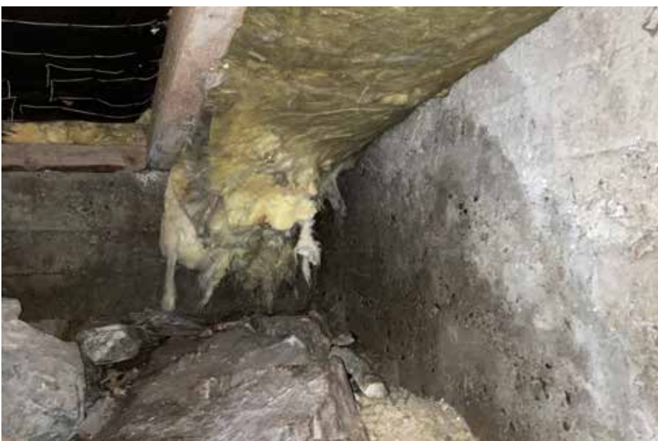
Krypkjellar, bilde tatt mot nordvest. Merk fuktmerker i muren her.
