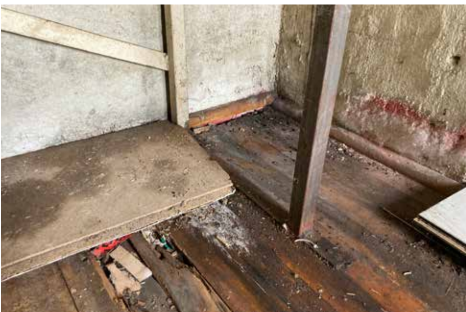
Rom 2. Fukt i golv.
