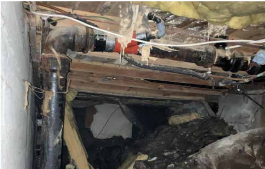
Krypkjellar, bilde tatt mot sørvest. I krypkjellar ser ein synlege fuktproblem, grunna av at muren ligg heilt inn i terrenget opp mot vest. Det ser ikkje ut til å ha blitt gjennomført drenering for å bøte på problemet. Merk også fuktskadar opp i golvet på dette bildet.
