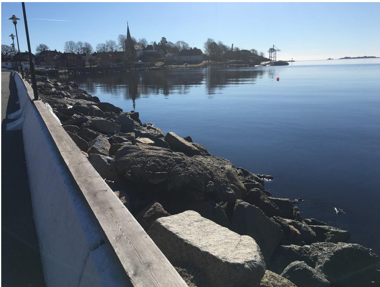
Figur 22 Larvik/Sanden: bølgeskjerm av betong sammen med grove steinblokker beskytter gangveien (i dette tilfellet ikke tilstrekkelig høyde på betongmur)
