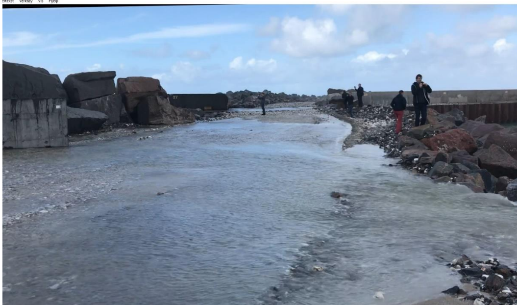
Figur 15 Vannstrøm som følge av bølgeoverskylling (Hirtshals). Vannmengden er stor nok til at uforberedt publikum vil oppfatte den som et vesentlig hinder. Godt utstyrte personer kan fortsatt ferdes på stedet. Antatt vannføring er 5 - 10 l/(sm)
