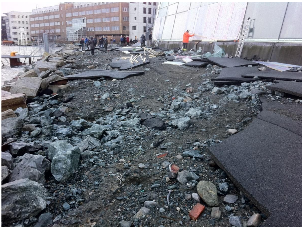
Figur 14 Skader etter storm ved Pirsenteret i Trondheim. Asfaltdekket er revet opp slik at grusdekket under er eksponert. Bølgene har løftet steiner opp og kastet dem mot glassfasaden.
