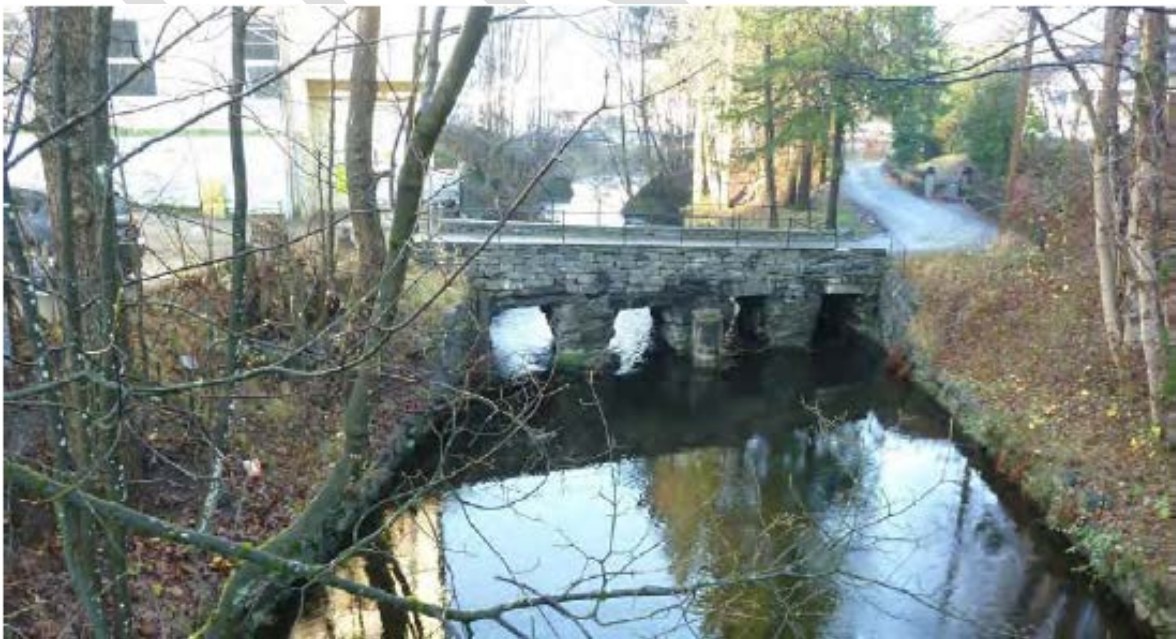
Figur 4. Wernerholmsbroen, sett nedover (Foto NVE). Krav til klaring på 0,5 m under broen ved Q_{200} er bestemmende for høyeste tillatte flomvannstand i Lille Hopsvann.
