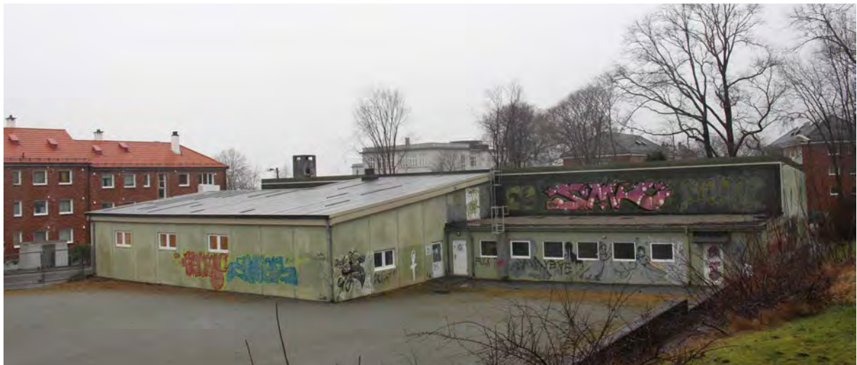
Figur 17 Gymnastikksalen har dårlig byggeteknisk tilstand og liten bruksverdi for skolen (foto: ORA)
