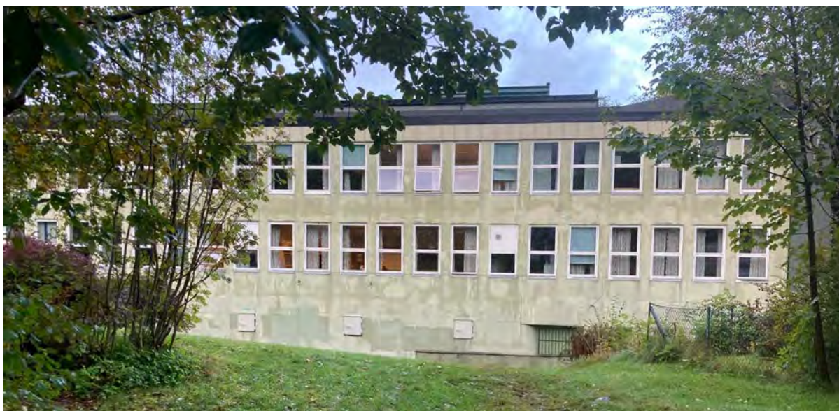
Figur 12 Fasaden mot øst. Lik vindusinndeling i stramme vindusbånd. Også her er det synlig manglende vedlikehold. (foto: ORA)
