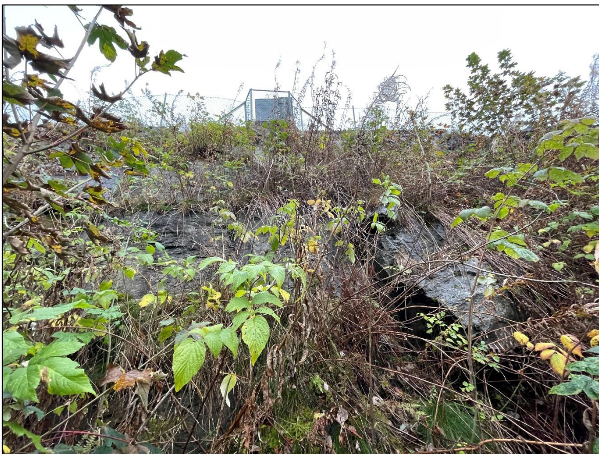
Figur 3. Lødd tørrmur i underkant av Korglia 26.
