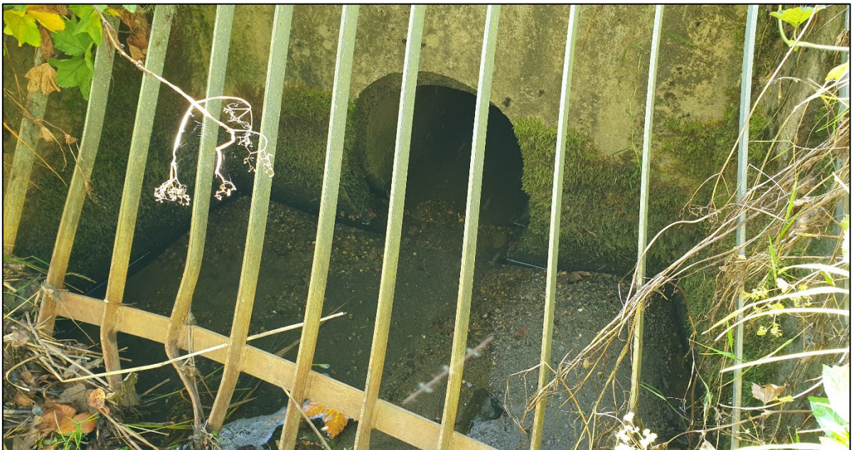
Figur 22 Det lille vassdraget som renner nord-sør gjennom planområde øst, er lagt i rør like nord for planområde øst, på oppsiden av den gruslagte turvegen og fortsetter i rør helt ned til Myrvatnet. Her vises inntaket til overvannsrøret. Foto: M. Bjerga, Multiconsult.
