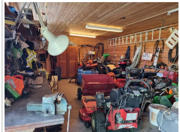
Bilde nr. 2.38 Garasjens innervegger av trepanel. Løsøre står i veien for observasjon av hele vegger.
