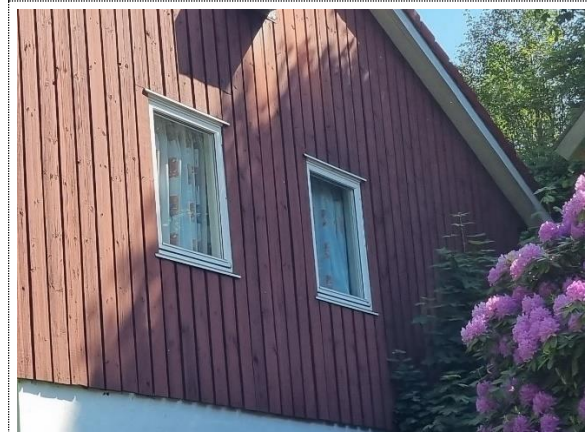
Bilde nr. 2.26 Vinduer i 1.etg. har beslag i underkant og overkant av vinduene.
