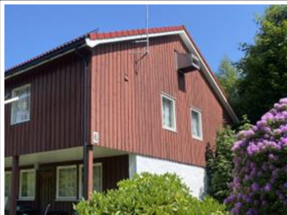
Bilde nr. 3.01 Luftinntak til byggets ventilasjonssystem.
