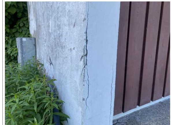
Bilde nr. 2.04 Nærbilde av vertikale riss i ende av betongvegg. Veggen er samme betongvegg som vises på bilde nr. 2.03.
