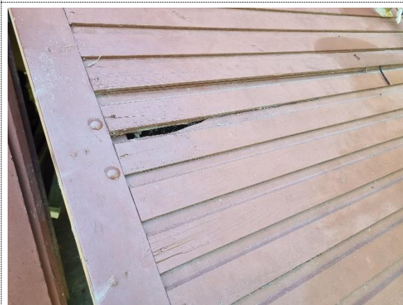
Bilde nr. 2.31 Nærbilde av garasjeport med skade.
