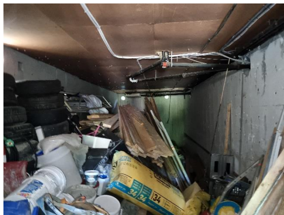
Bilde nr. 2.05 Krypkjeller. Uisolert betongvegg til venstre i bildet. Isopor på kjellervegg til høyre. Løsøre oppbevares i krypkjeller.
