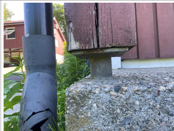
Bilde nr. 2.57 Sprukket nedløp på bygg 6.
