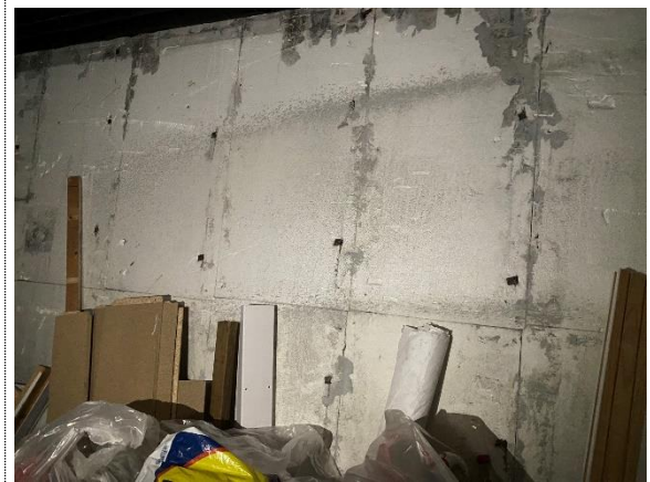
Bilde nr. 2.06 I krypkjeller. Kjellervegg mot innredet U.etg er isolert med isopor.
