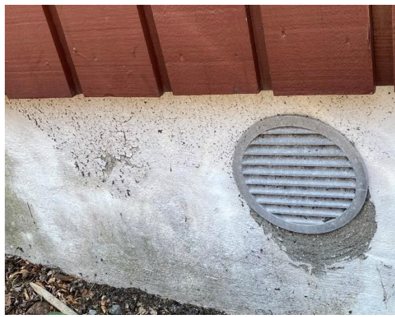
Bilde nr. 2.21 Nærbilde av betongvegg mot øst. Merker etter begroing og innsetting av ventil.
