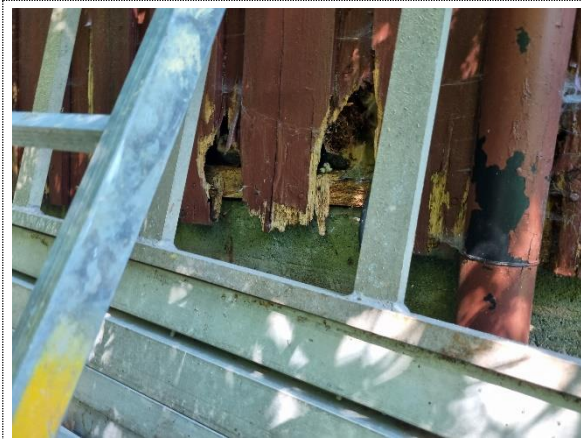
Bilde nr. 2.59 Avskallet maling på nedløp ved garasjen.
