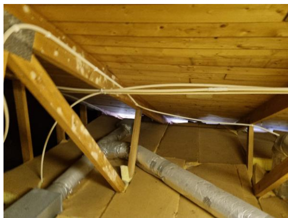
Bilde nr. 2.43 Bygg 4 Kaldloft, isolasjon over bjelkelag. Antar at etasjeskillet i bygg 6 er tilsvarende.
