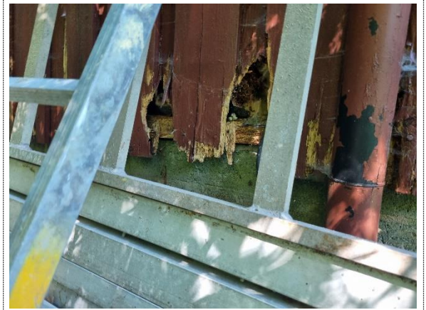
Bilde nr. 2.24 Nærbilde av råteskade på trekledningen til garasjens sørside.
