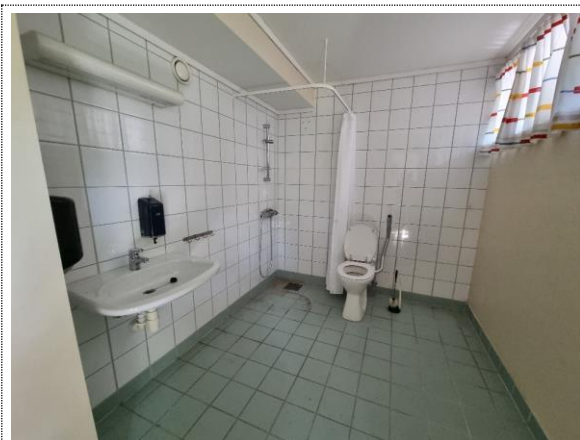
Bilde nr. 2.47 Bygg 4 Fliser på baderomsgulv. Antar at baderom i bygg 6 er tilsvarende som på bildet.
