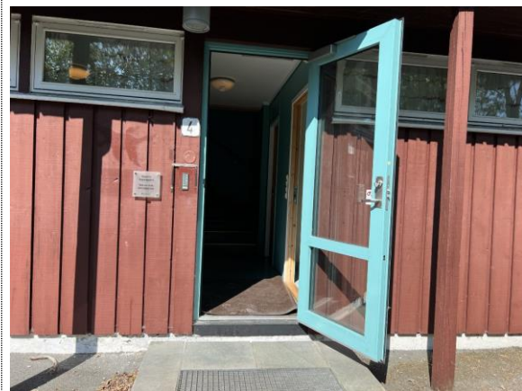
Bilde nr. 2.27 Bygg 4 Ytterdør i aluminium. Antar at inngangsdør på bygg 6 er tilsvarende bildet.
