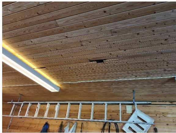
Bilde nr. 2.51 Garasjens himling av trepanel. Mekaniske skader.
