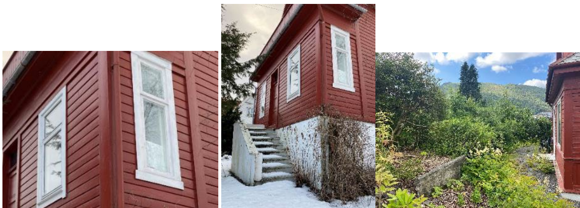
Figur 4-15 Wergelandsbakken 1 (gnr. 13/182), hushjørne mot nordøst. Detalj viser eldre og nyere vindu. Lengst til høyre det oppmurte platået på sørsiden av eiendommen.
