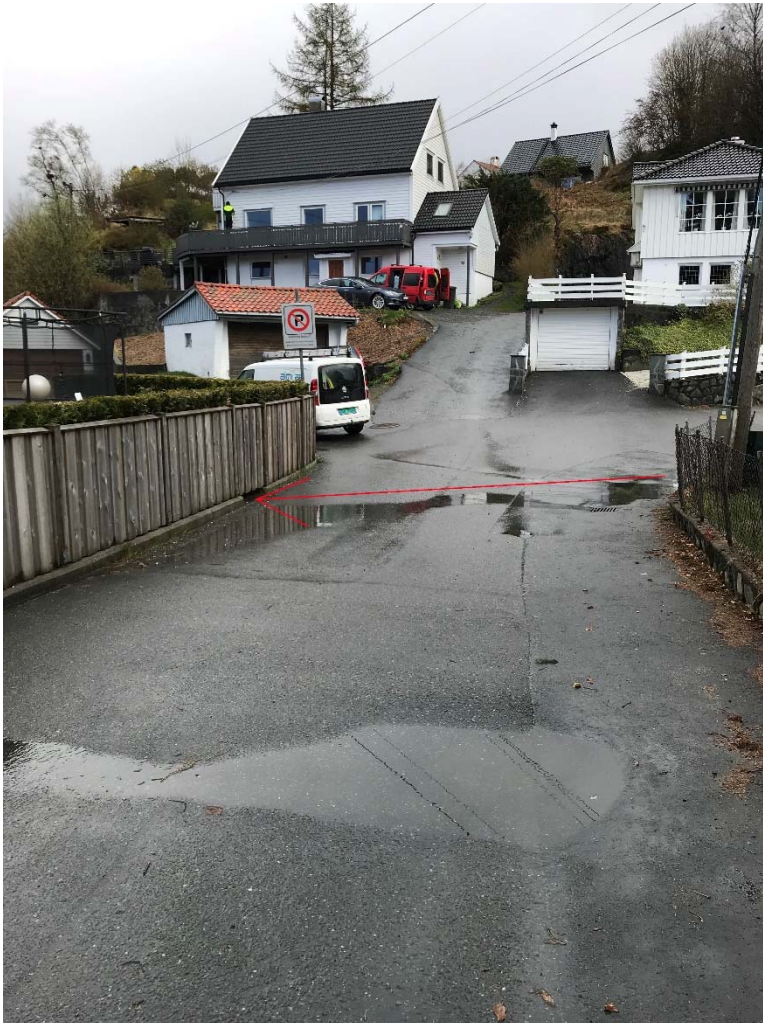
Figur 6: Figuren viser lavbrekk i innkjørselen til Hjortevegen 10-26. Rød pil viser flomvei for nedbørsfelt A1.
