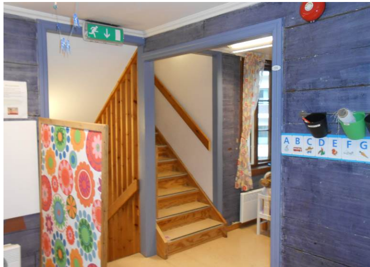
Figur 10. Bildet med den blåmalte laftet viser en ny åpning i konstruksjonen tatt i 1992. Øverste omfar står igjen, slik at man ser at det tidligere har vært en vegg her (Foto: Byantikvaren 2015).
