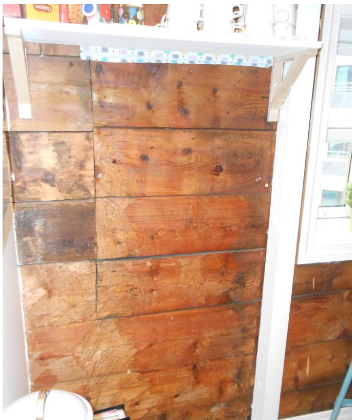
Figur 18. En tidligere åpning i konstruksjonen som er lukket med laftplank. Tilhuggingene som man ser i overgangen har vært gjort for å jevne ut uregelmessigheter på veggen (Foto: Byantikvaren 2015).
