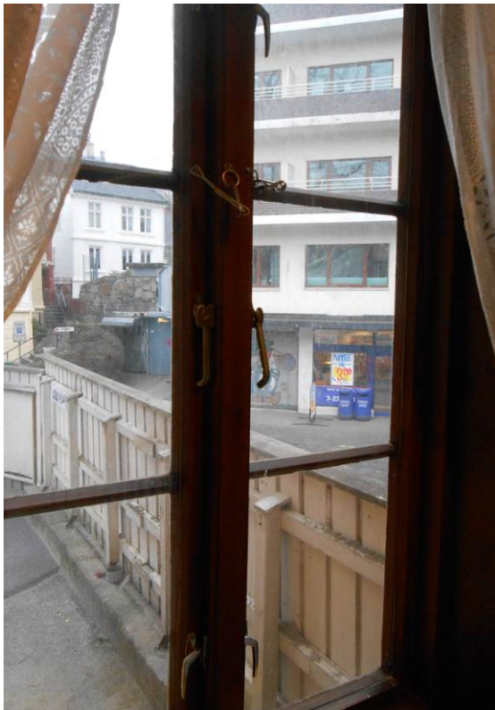
Figur20. Vinduene ble skiftet i 1992 (ser vi av byggesøknaden). Det er forholdsvis gode kopier av historiske vindu, selv om alle hempene er av moderne type (Foto: Byantikvaren 2015).
