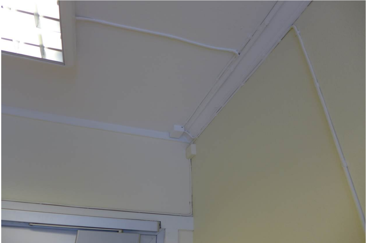
Figur 15. Utenpåliggende strømedninger og gamle taklister indikerer at bygningens opprinnelige flater er godt bevart (Foto: Bergen kommune, Byantikvaren 2015).
