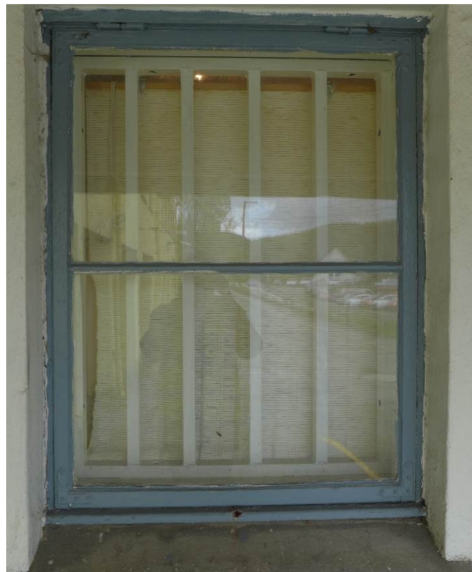
Figur 10. Gammelt vindu i kjelleretasjen på byggets fasade mot nord (Foto: Bergen kommune, Byantikvaren 2015).
