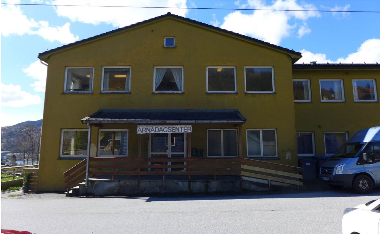
Figur 8. Fasade mot øst. Døren er moderne, mens enkelte av vinduene er gamle. Takoverbygget er trolig en tilføyelse (Foto: Bergen kommune, Byantikvaren 2015).
