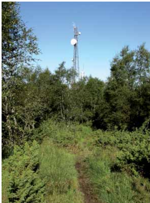
Telemast ved Torneberget.
