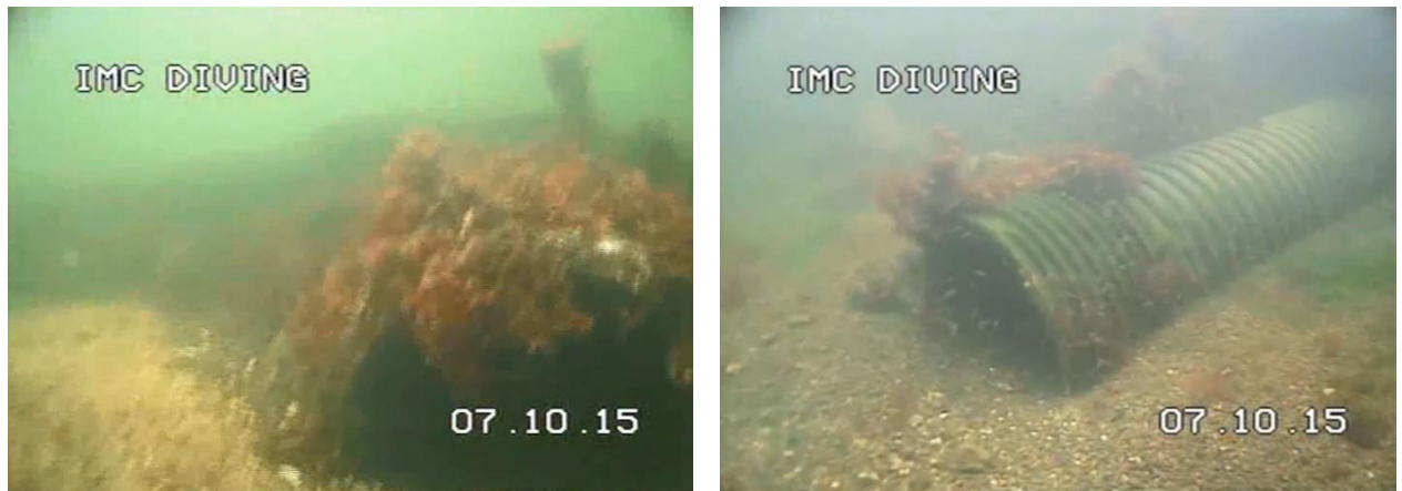
Figur 11 Delvis blokkerte overvannsutløp. Venstre: utløpsrør vest i Kirkebukten. Høyre: utløpsrør i øst. Bilder fra video, IMC Diving
