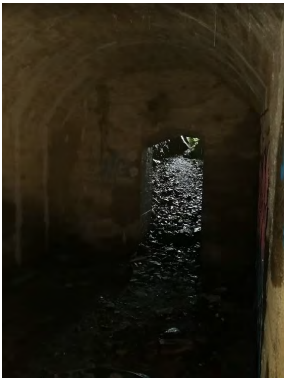
Figur 69: Inne i tunnelen ved Trengereidsbrekka, utgang mot Sørffjorden (Foto: Bergen kommune, Byantikvaren 2019).
