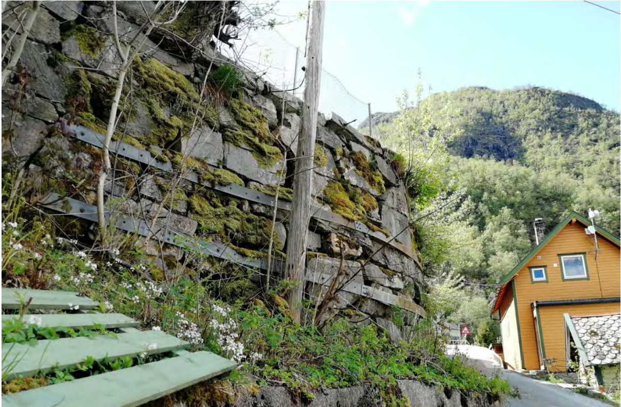
Figur 16: Eksempel på støttemurer langs Trengereidbrekka. På platået i overkant av muren ligger Trengereid stasjon. Muren er forsøkt forsterket med metallbånd (Foto: Byantikvaren, Bergen kommune 2019).
