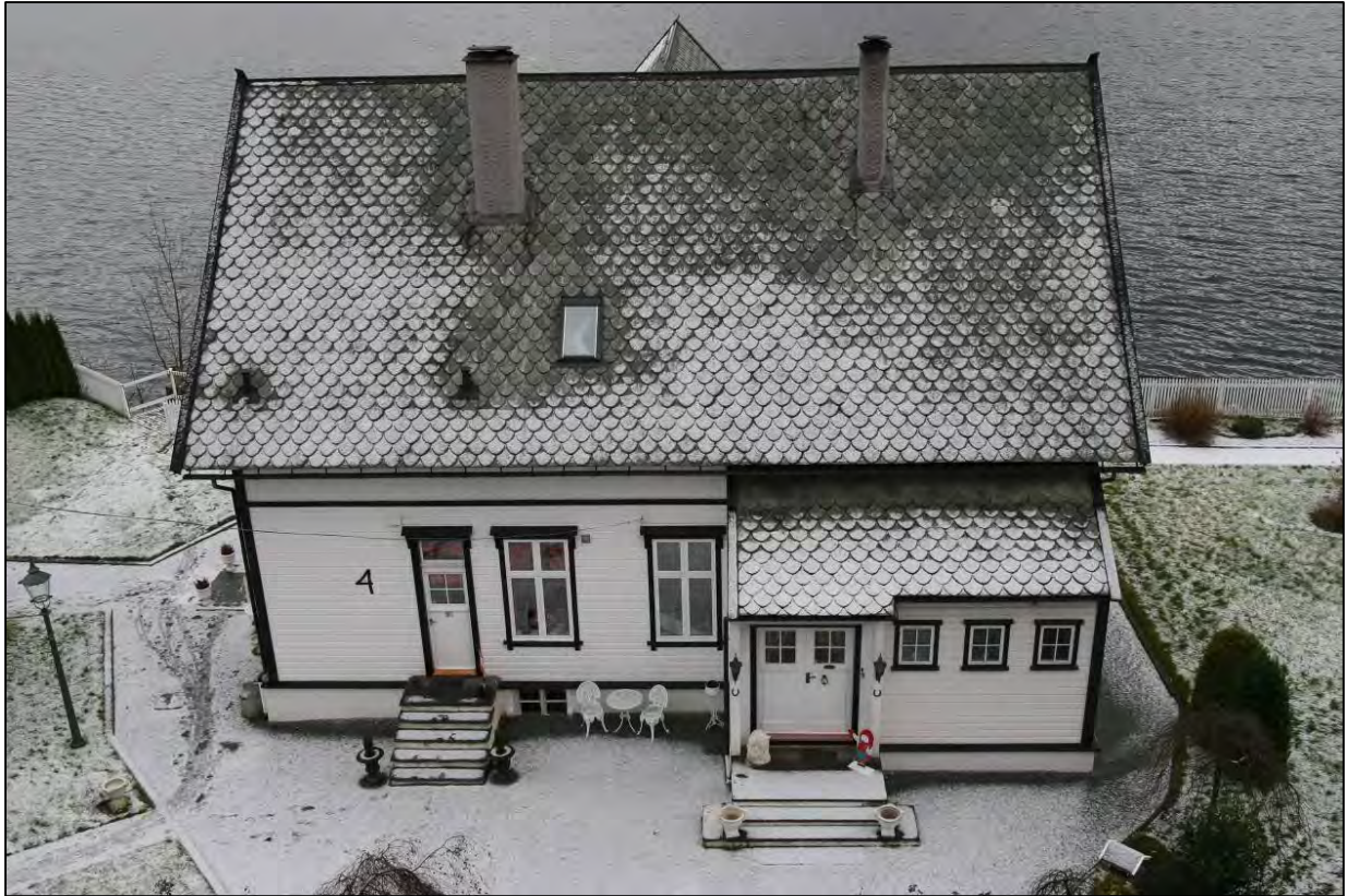
Figur 33. Elvevegen 4, oppført 1896. Huset var direktørbolig for J.W Fenton og J.A. Hodkinson (Foto: Byantikvaren 2012).
