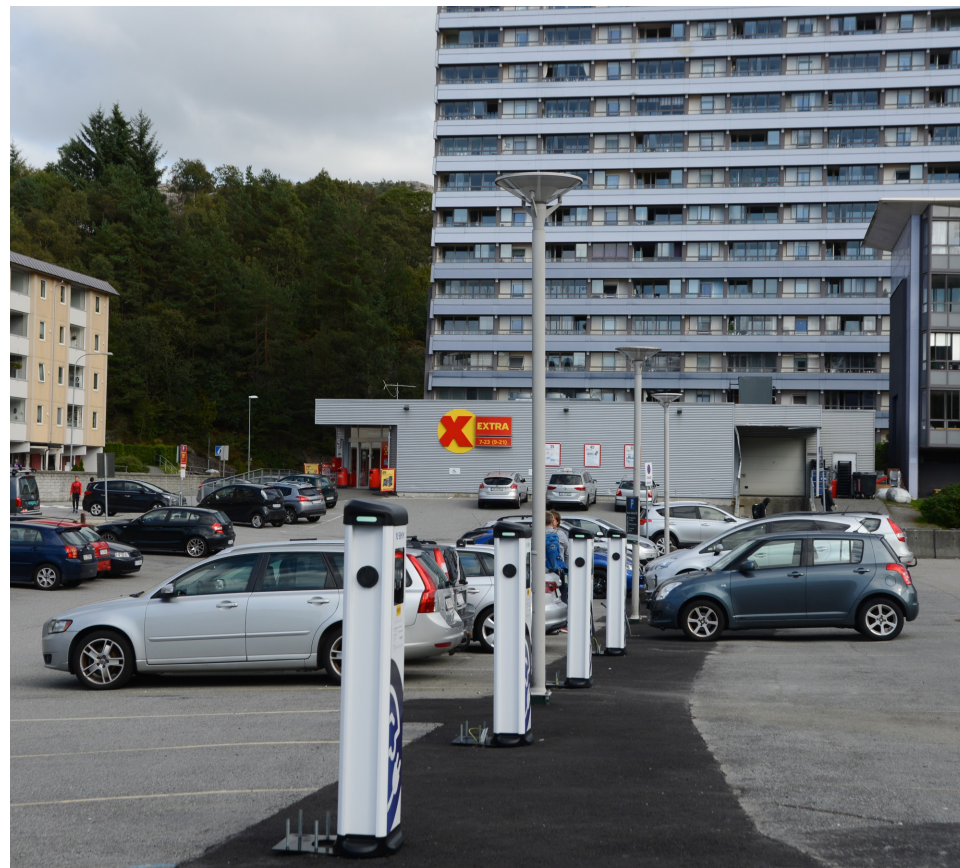
Bilde: Eksempel på sambruk av ladeinfrastruktur. Foto: Bergen kommune.
