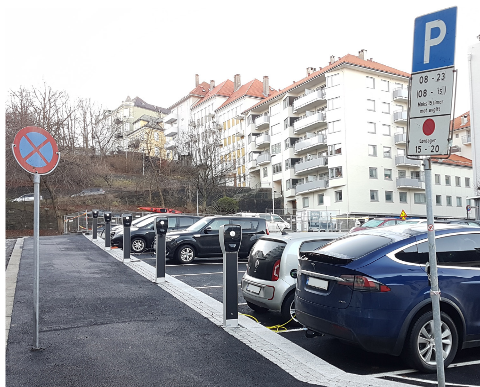
Bilde: De fleste kommunale ladeanlegg har kapasitet for økt utnyttelse. Foto: Bergen kommune.
