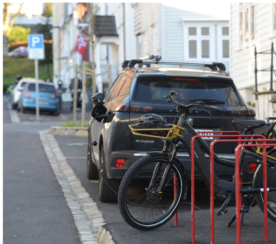
Bilde: Ladepunkt etablert langs kommunal vei. Foto: Bergen kommune.
